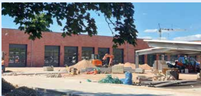
So sah es Ende August noch auf der Baustelle Gondelteich aus. Foto: P. Fischer
